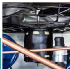
Motor y ventilador
