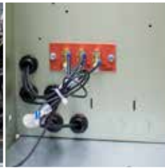
Tablilla de conexiones
